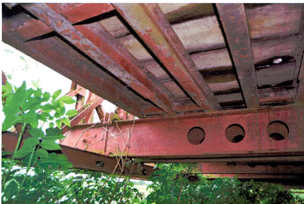
Uszkodzenia powłoki ochronnej z farby oraz korozja konstrukcji mostu
